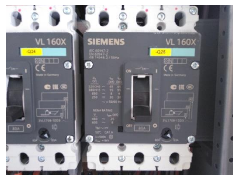
Circuit Breaker แต่ละชุด (สามารถอ่านข้อความได้)
