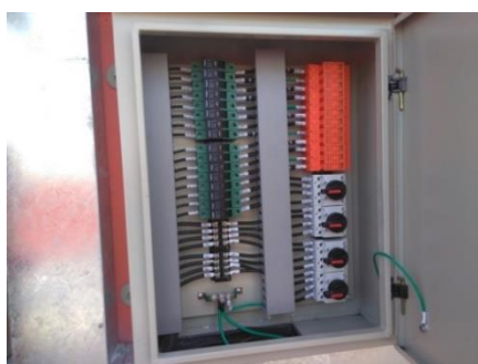
ตู้ฟิวส์/CB ที่ใช้ป้องกันแผงก่อนเข้าอินเวอร์เตอร์
