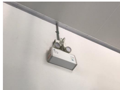
แสงสว่าง/ไฟฟ้าฉุกเฉิน
