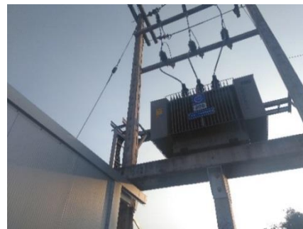
หม้อแปลงไฟฟ้า (ที่เชื่อมต่อ กับระบบ Solar )
