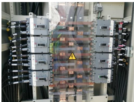
ภาพรวม Circuit Breaker ของอินเวอร์เตอร์
