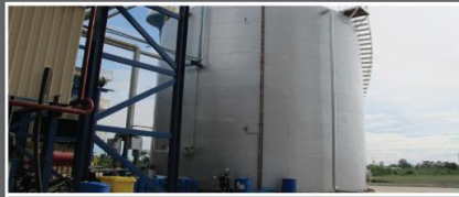
อาคารอื่นๆ เช่น ถังเก็บของที่มีความจุตั้งแต่ 100 ลูกบาศก์เมตรขึ้นไป
