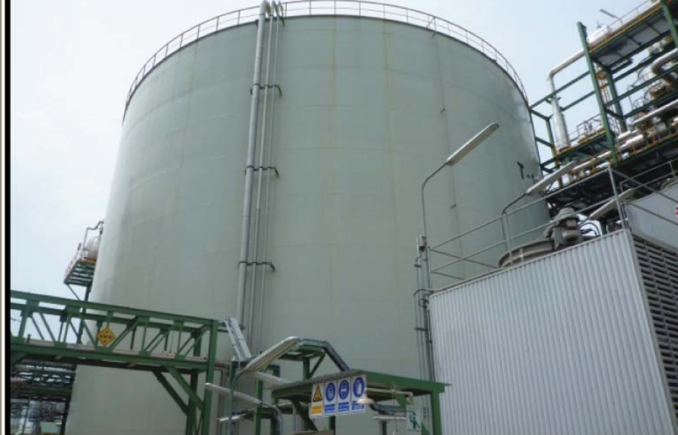
6. ถังน้ำ Demineral ที่มีความจุตั้งแต่ 100 ลูกบาศก์เมตรขึ้นไป
