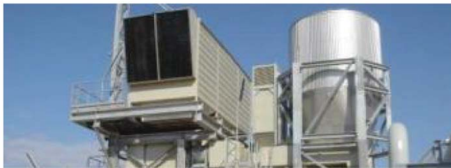
5. สถานีปรับความดันก๊าซ (Compressor Station)
