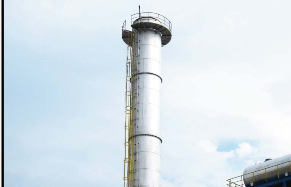
3. ปล่องระบายอากาศเสีย (Stack) ที่มีความสูงตั้งแต่ 10 เมตรขึ้นไป
