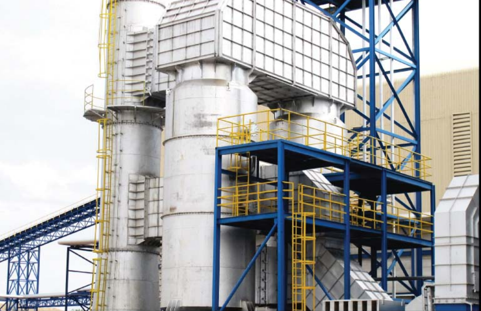
9. อาคารควบคุมมลพิษทางอากาศ (ESP)
