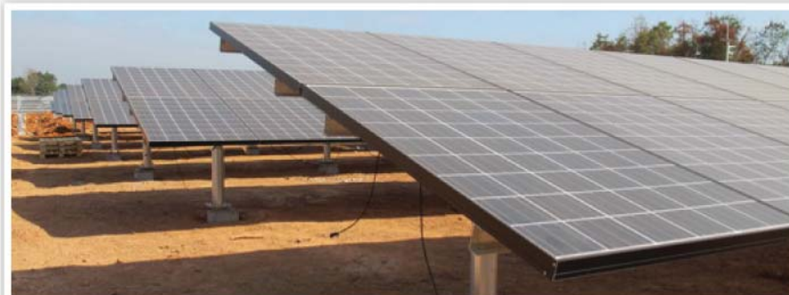
1. โครงสร้างแผงโซลาร์เซลล์ (Solar Cell Panel)
