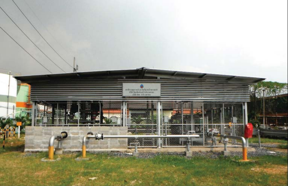
9. สถานีควบคุมก๊าซธรรมชาติ
