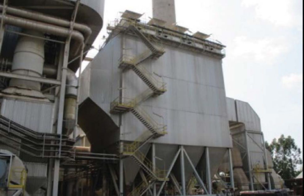
4. อาคารควบคุมมลพิษทางอากาศ (ESP)
