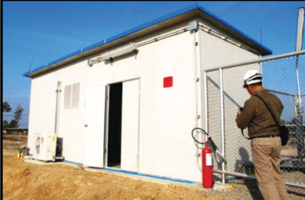
2. อาคารควบคุมระบบอินเวอร์เตอร์
