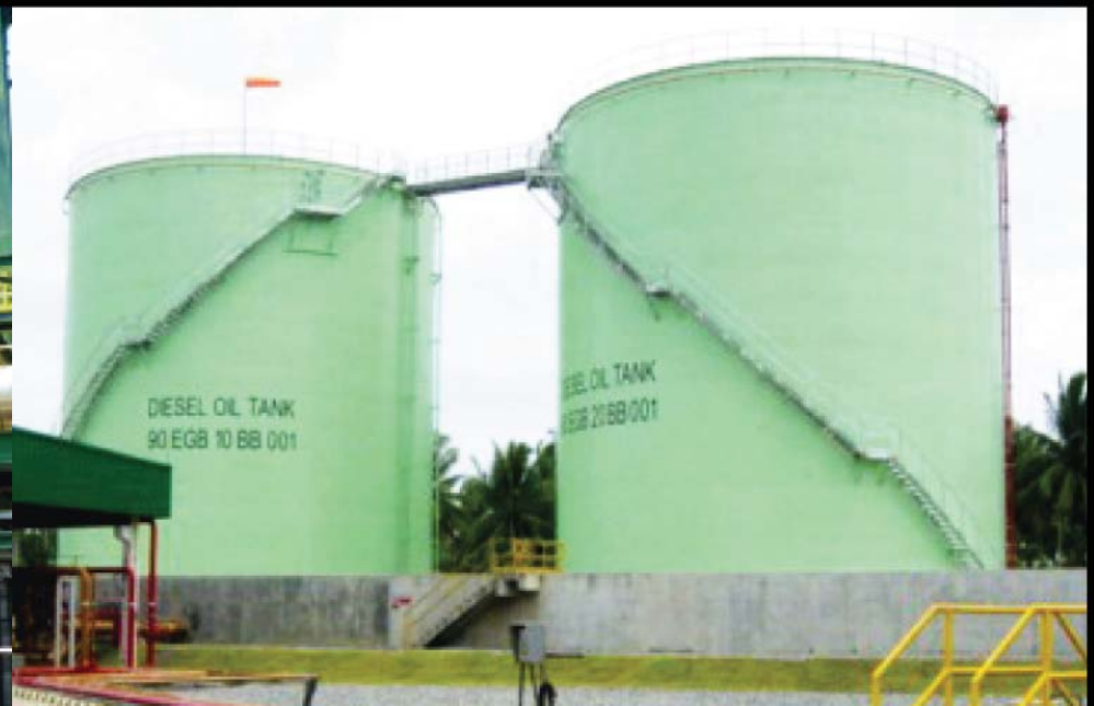
8. ถังน้ำมันดีเซลสำรอง ที่มีความจุตั้งแต่ 100 ลูกบาศก์เมตรขึ้นไป
