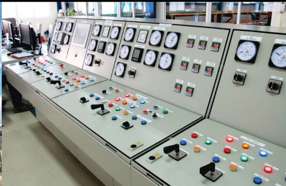
4. อาคารควบคุมการผลิตและจำหน่ายไฟฟ้า
