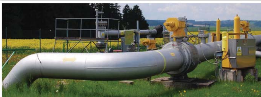
6. ท่อส่งก๊าซ/ระบบวาล์ว เปิด-ปิด
