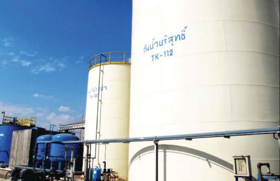
5. ถังน้ำ Demineral ที่มีความจุตั้งแต่ 100 ลูกบาศก์เมตรขึ้นไป
