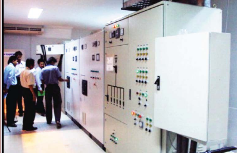
5. อาคารควบคุมการผลิตและจำหน่ายไฟฟ้า
