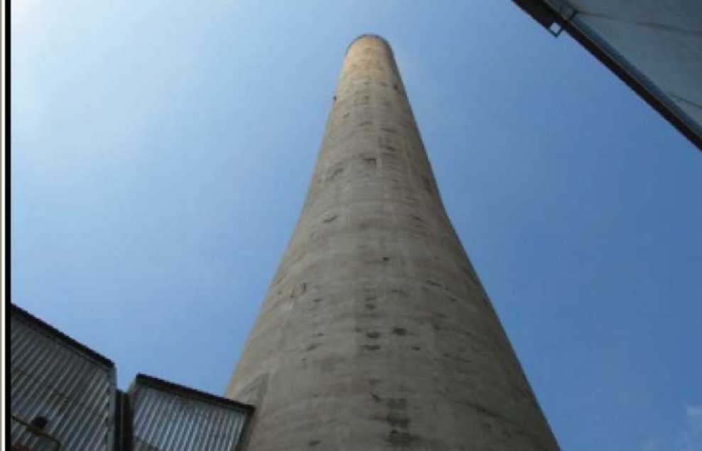
10. ปล่องระบายอากาศเสีย (Stack) ที่มีความสูงตั้งแต่ 10 เมตรขึ้นไป
